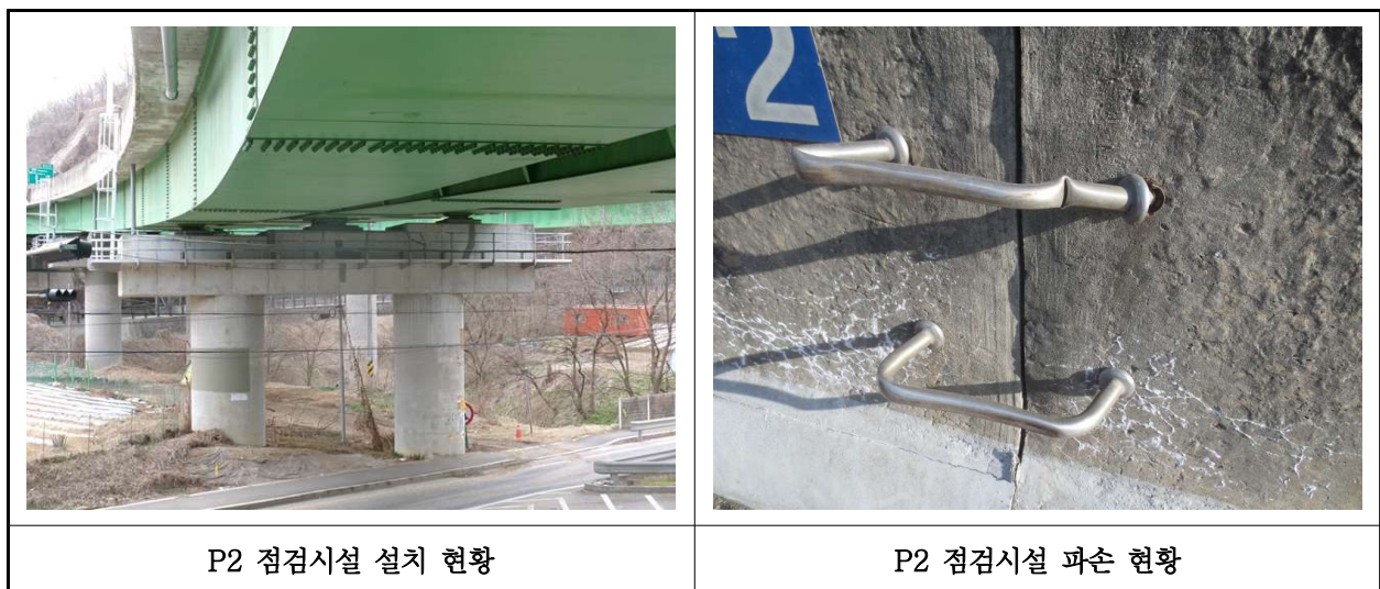
【사진 1.7.3】 점검시설 설치현황
