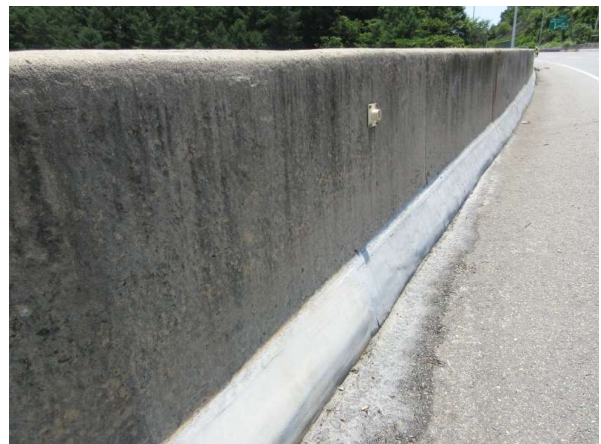
방호벽 델리네이트 파손 S2
